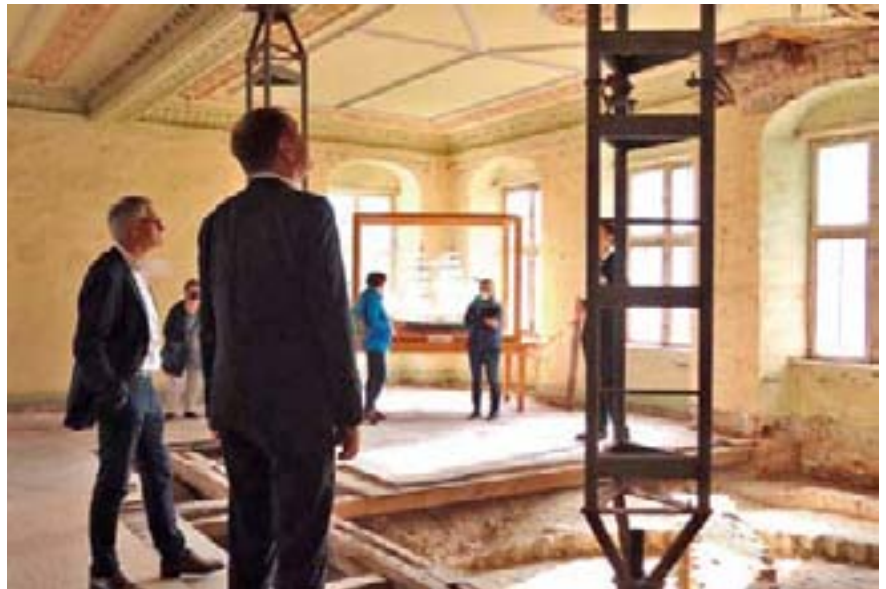
Die Ausschussmitglieder besichtigen einen der sanierungsbedürftigen Räume im Schloss Ludwigsburg.
