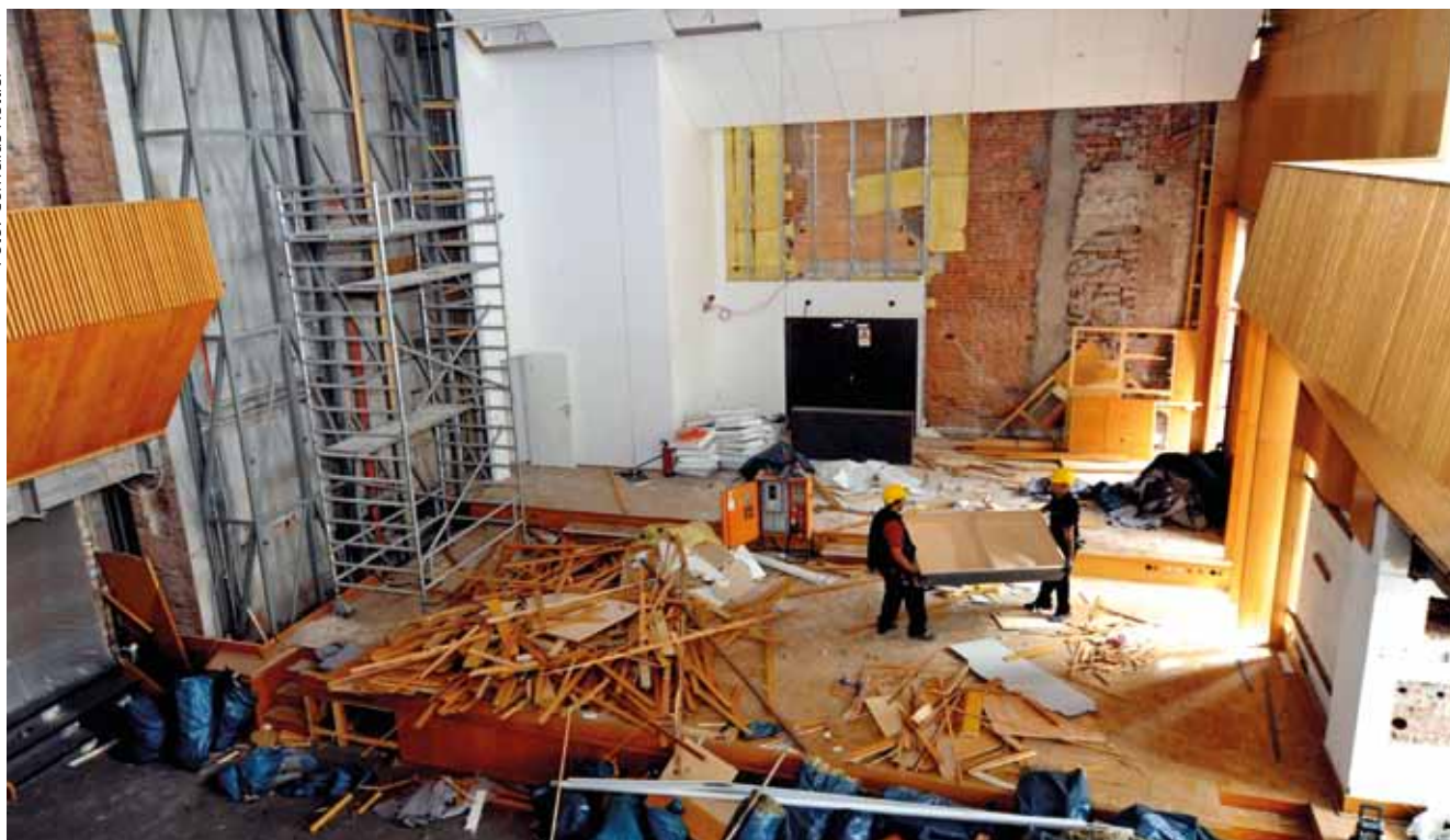
Zur Untersuchung der Bausubstanz wurden im Festsaal zunächst die Stuhlreihen ausgebaut und die Einbauten abgebrochen.
